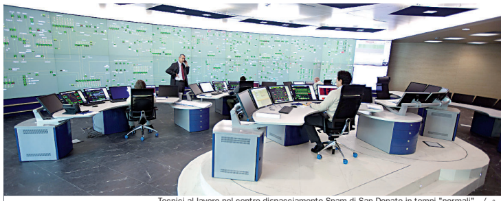
Tecnici al lavoro nel centro dispacciamento Snam di San Donato in tempi "normali" / Snam
